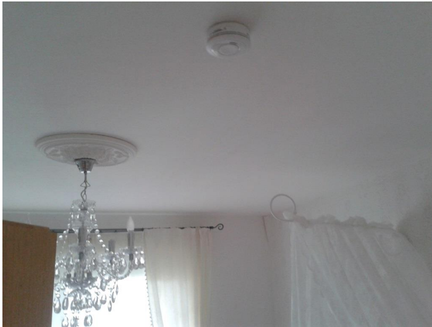
Installationsbeispiel in einem Schlafzimmer
